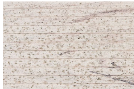
Stockflecken/Schimmel auf der Oberfläche
