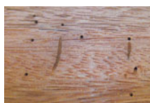
„Pinholes“ bei überseeischen Harthölzern
